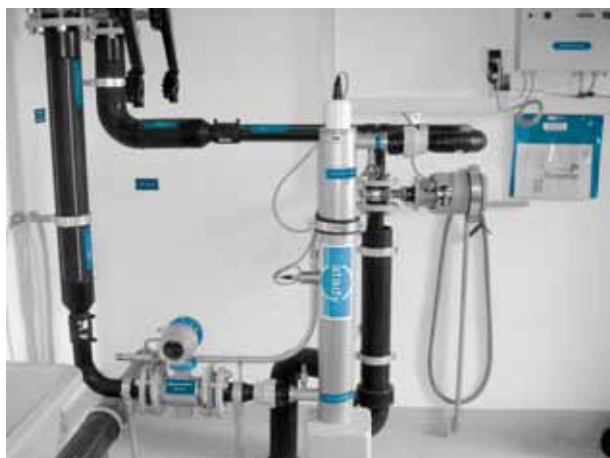
Abb. 5.6.1 Beispiel einer UV-Entkeimungsanlage in einer kleinen Wasserversorgung
